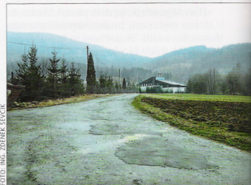
V Morávce mají celkem 13,96 km místních komunikací. Z nich 12,294 km je asfaltových. Téměř třetina z »asfaltek« je však v nekvalitním stavu (výtluky apod.).
